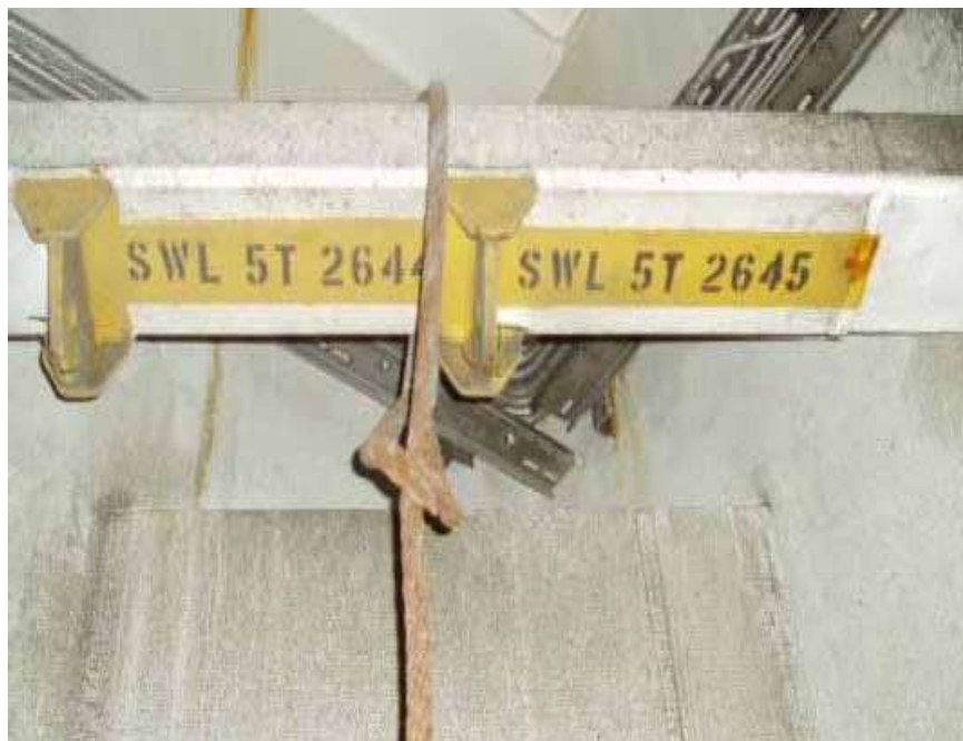
Utilisation incorrecte des élingues et de l'équipement de levage
